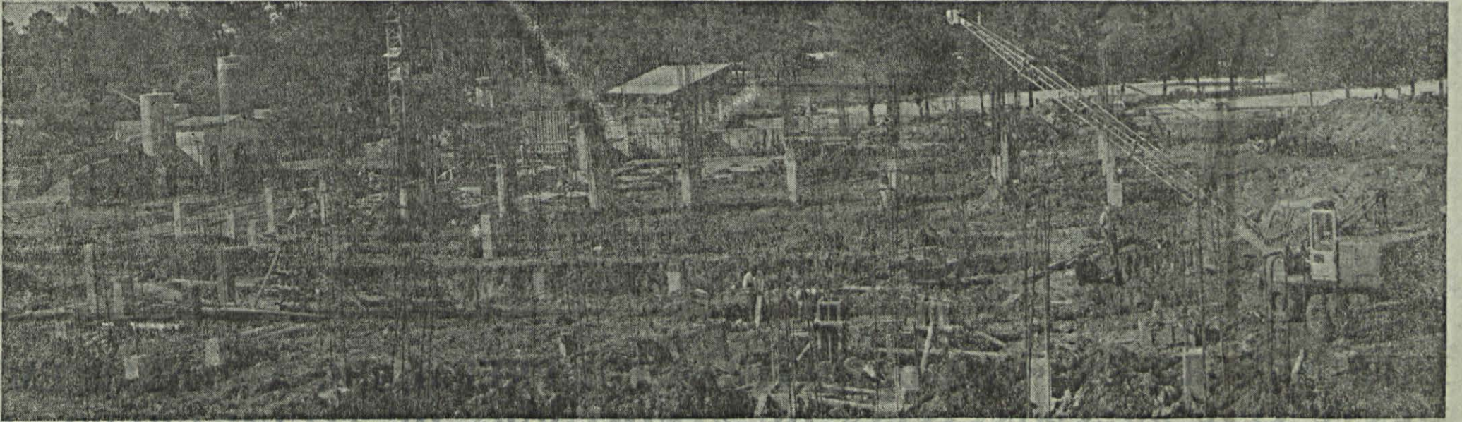
UM NOVO E IMPORTANTE EDIFÍCIO ESTÁ A SER CONSTRUÍDO NO PERÍMETRO DO SANTUÁRIO DE FÁTIMA. TRATA-SE DO CENTRO PASTORAL DE PAULO VI, CUJA PEDRA INAUGURAL FOI BENZIDA NO DIA 13 DE MAIO, DURANTE A GRANDE PEREGRINAÇÃO ANIVERSÁRIA.
